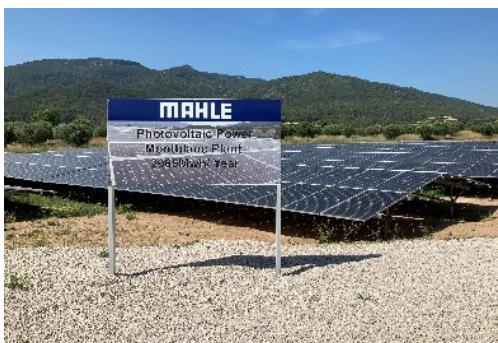
Strom aus eigenen Photovoltaik-Anlagen – hier die PV-Anlage im MAHLE Werk in Montblanc/Spanien – ist nur eine Maßnahme der Nachhaltigkeitsstrategie von MAHLE
